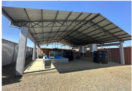
Planta de Tratamiento de Aguas Residuales (PTAR)
